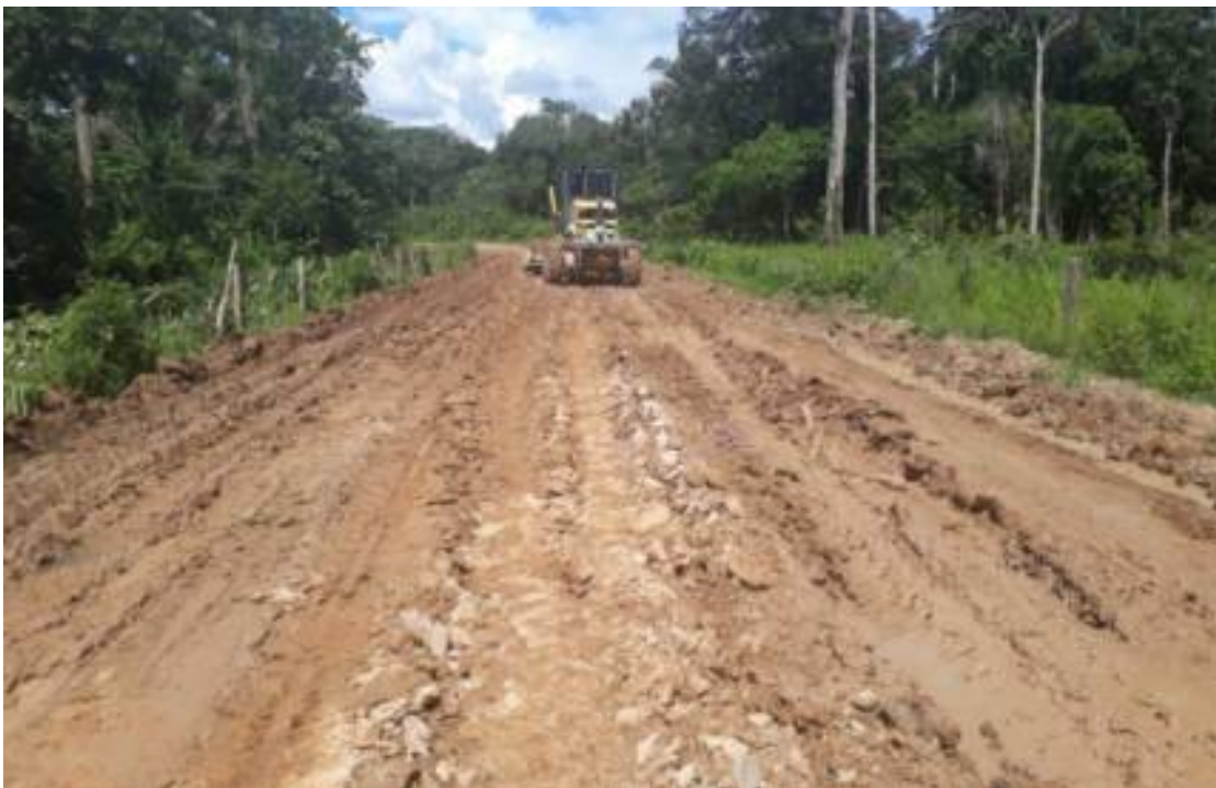
FOTO No 6 MATERIAL PERMANENTEMENTE SATURADO POR CONDICIONES DE LLUVIA Y CERCANIA A LOS DOS COSTADOS DE AGUAS RETENIDAS, COINCIDENTE EN TODO EL TRAMO
