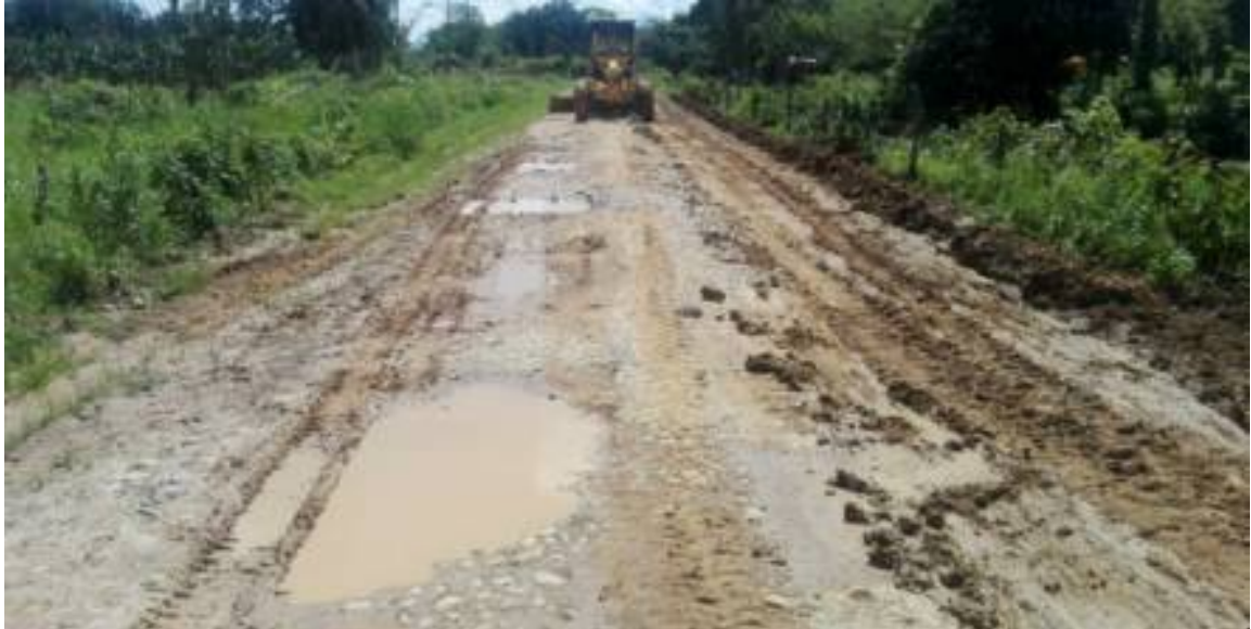
FOTO No 1 ESTADO INICIAL DE LA VÍA
